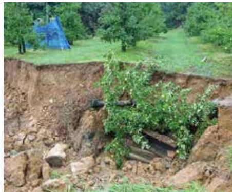
▲大雨で崩落した果樹園地（令和6年7月・由利本荘市）
