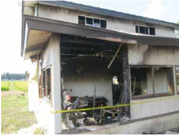
▶雷が落ち、火災事故が発生した住宅 (令和5年8月・大仙市)
