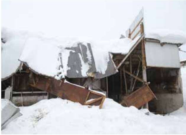
▶雪の重みで倒壊した堆肥舎 (令和3年1月・横手市)
